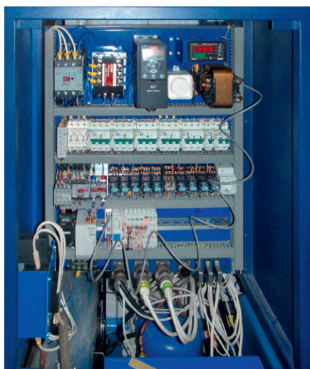
Рис. 3. Шкаф с оборудованием информационно-измерительной системы
