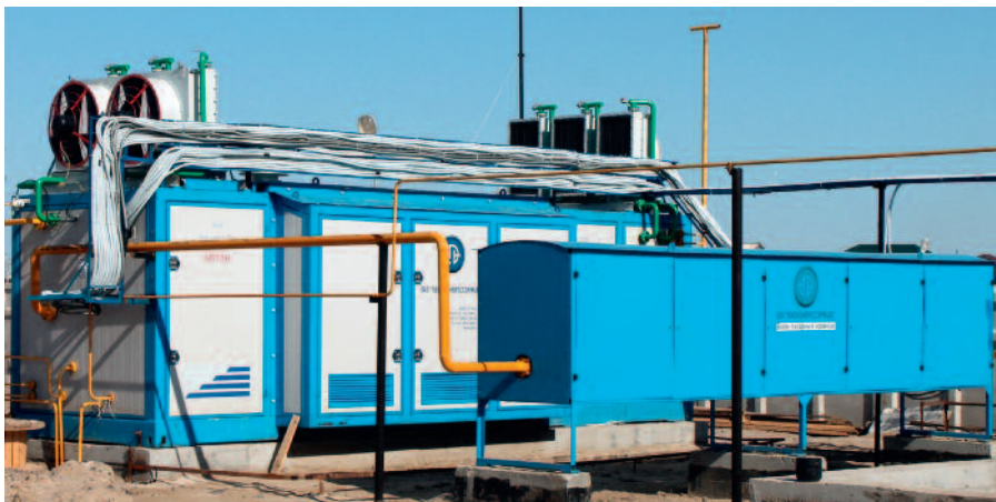
Рис. 8. Компрессорная станция, входящая в состав АГНКС
