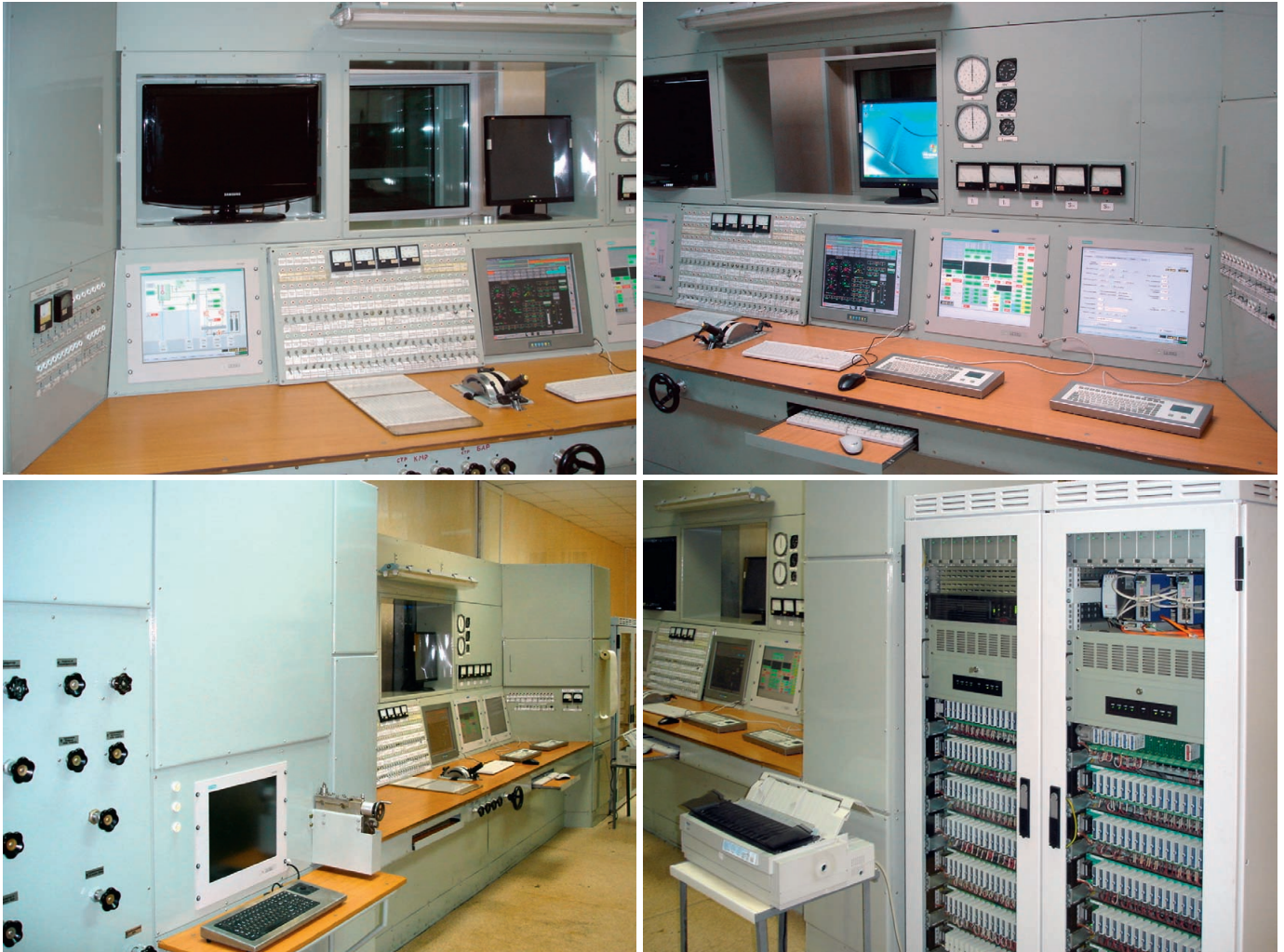
Внешний вид кабины наблюдения испытательного стенда
