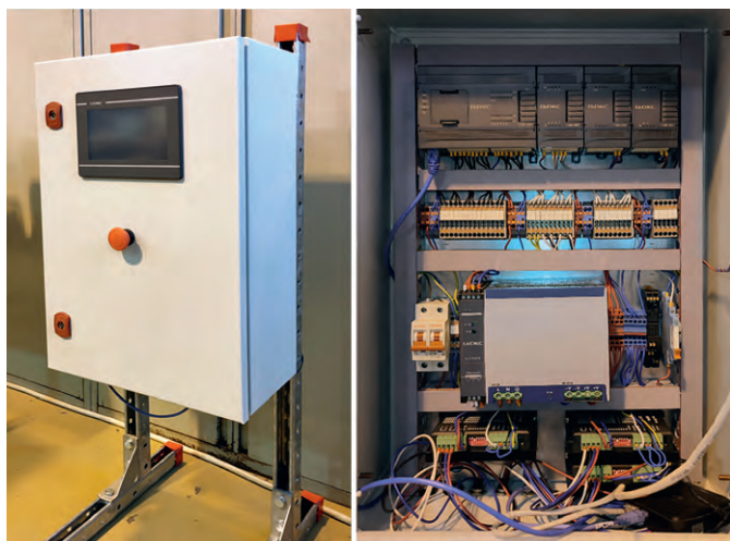
Рис. 2. Стенд № 1. Слева – шкаф управления дельта-манипулятором; справа – оборудование внутри шкафа
