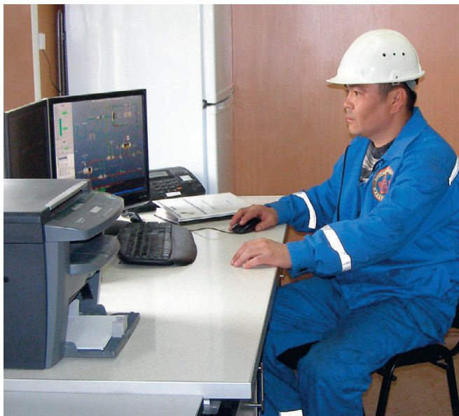
Рис. 5. Автоматизированное рабочее место оператора в блоке контроля и управления на площадке Аксаз
