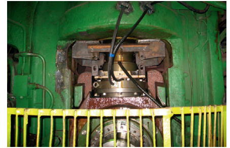
Рис. 7. Мембранные гидрокапсулы, установленные в пазах подушек верхнего валка
