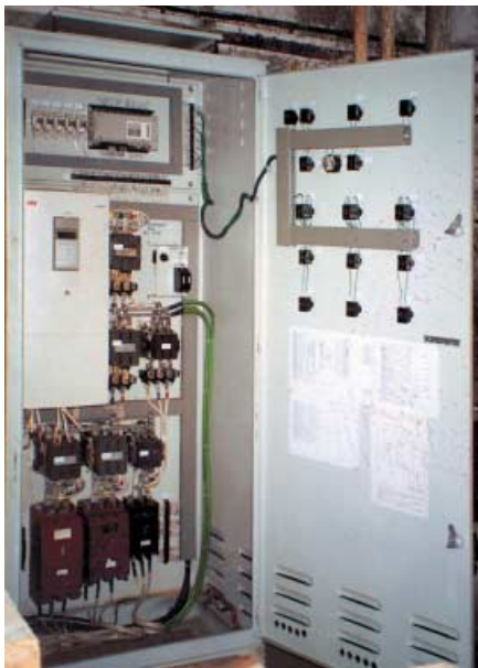
Рис. 7. Станция управления 2 насосными агрегатами, использующая модуль LOGO!
