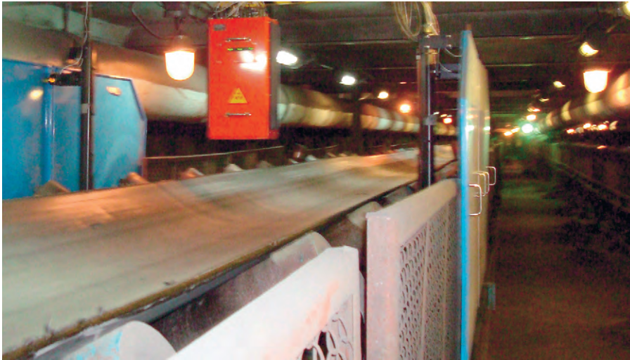
Рис. 3. Рудоконтролирующая станция, установленная на конвейере
