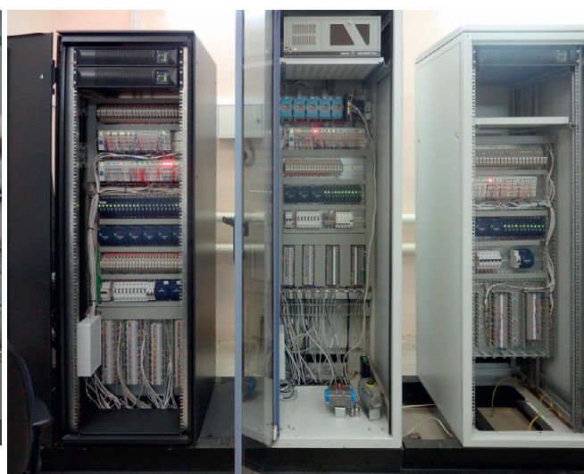
Рис. 6. Внешний вид контроллерных шкафов
