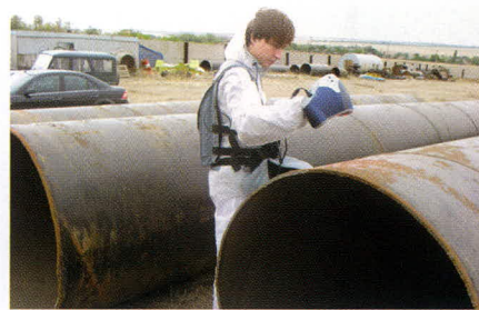
Рис. 3. Сканирование зоны коррозии на трубе
