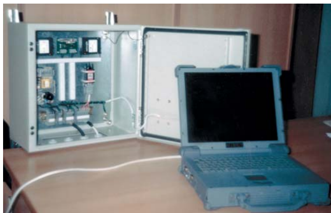
Рис. 3. Рабочая станция и шкаф устройства ввода-вывода
