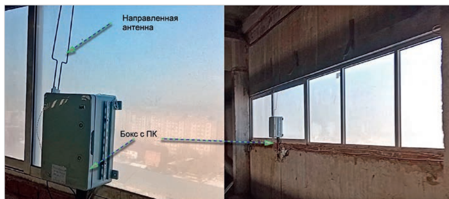
Рис. 5. Место установки ПК(x10) на верхней галерее элеватора
