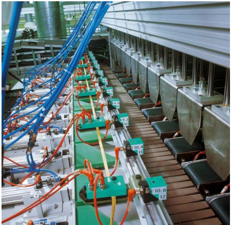
Рис. 1. Оборудование сети AS-интерфейса для конвейерной линии
