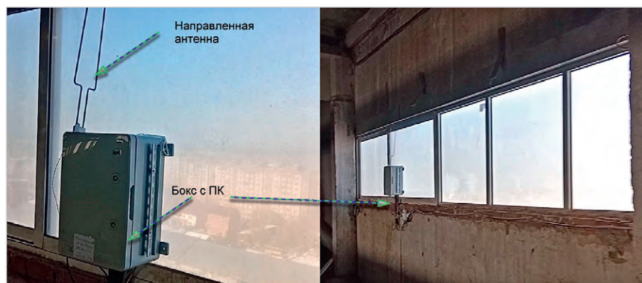
Рис. 5. Место установки ПК(x10) на верхней галерее элеватора
