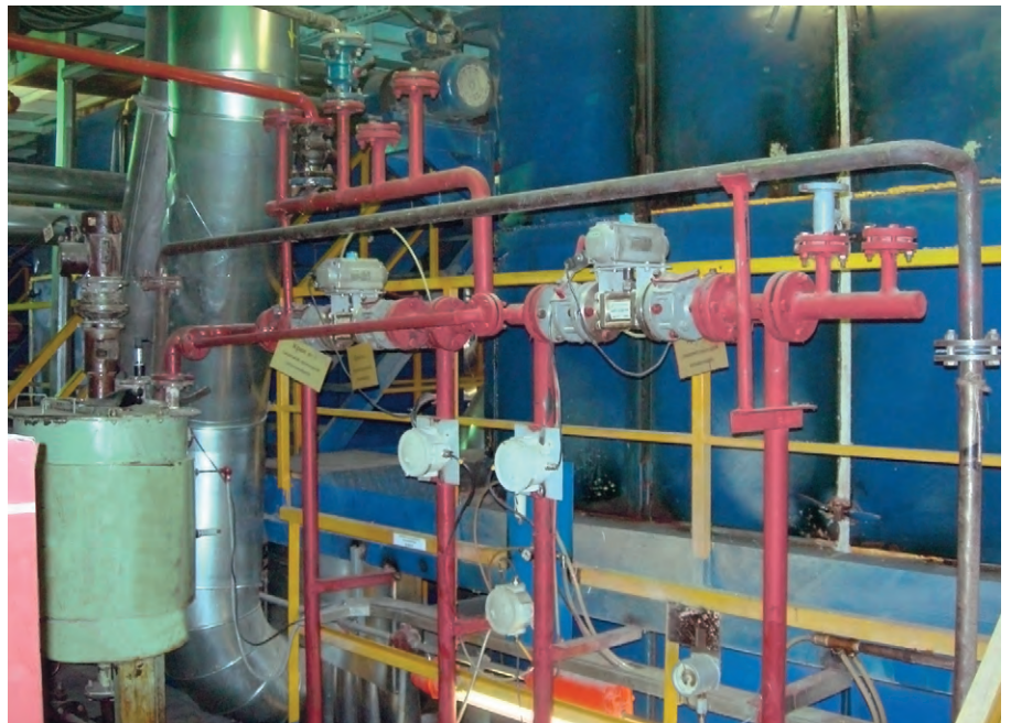
Рис. 5. Трубная разводка подачи лаков и запорная арматура ШКП 1,6-050НЖ
