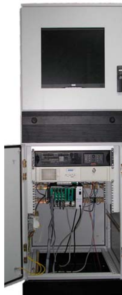
Рис. 3. Размещение устройств в индикаторном шкафу
