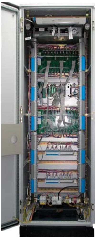
Рис. 2. Размещение устройств в измерительном шкафу
