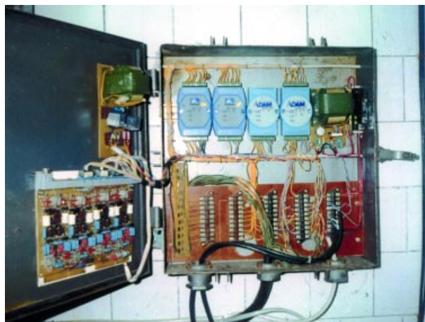
Рис. 4. Шкаф с оборудованием в эжекторной
