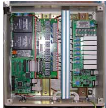
Рис. 10. Монтажная панель контроллера PE2.781.001 системы ЦВА
