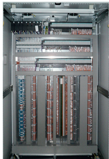
Рис. 3. Контроллерный шкаф АСУ ТП ГОТ К2
