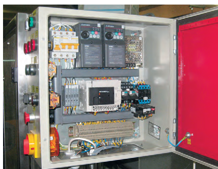
Рис. 4. Пример монтажа контроллера FX3G, а также преобразователя частоты FR-D700 в шкафу управления укупорочной машины
