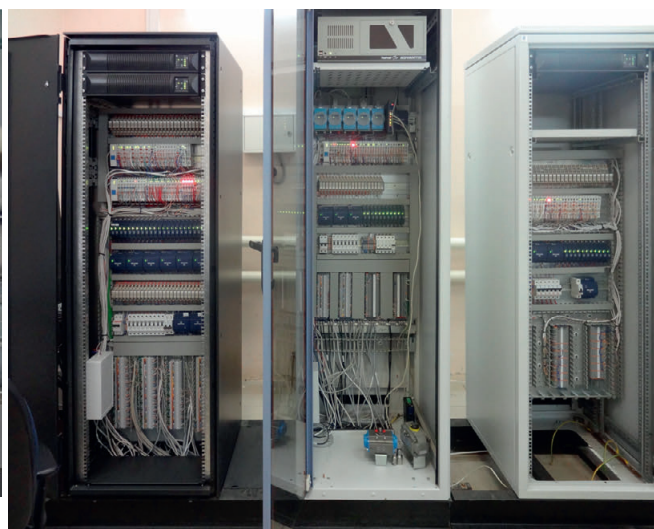
Рис. 6. Внешний вид контроллерных шкафов
