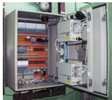
Рис. 3. Технологическая станция, обслуживающая 20 резервуаров парка
