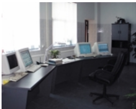
Рис. 4. Комната операторов АСУ ТП
