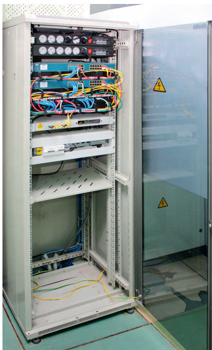
Рис. 3. Шкаф комплекса технических средств связи службы Э
