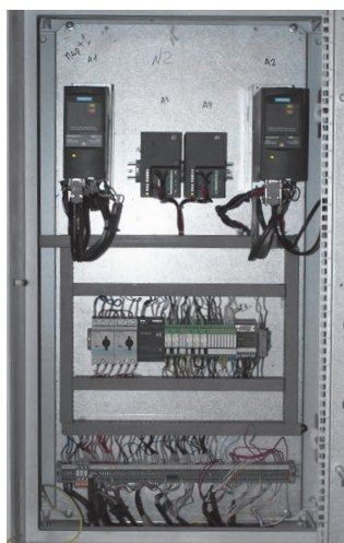
Рис. 3. Шкаф управления электроприводом
