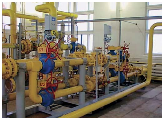
Газораспределительная станция, участок измерения расхода газа
