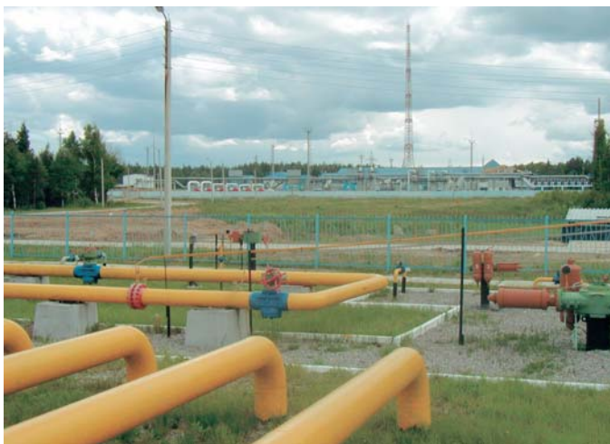
Вид на компрессорную станцию
