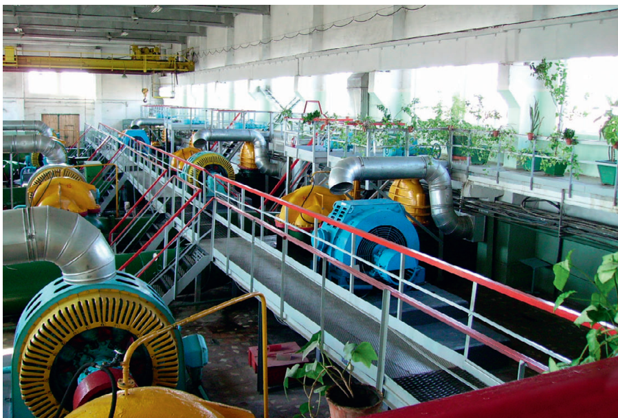
Рис. 2. Машинный зал насосной станции НС-5
