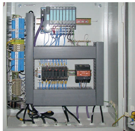
Рис. 4. Шкаф удалённого ввода-вывода
