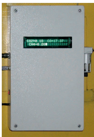
Рис. 3. Электронное табло на панели шкафа управления
