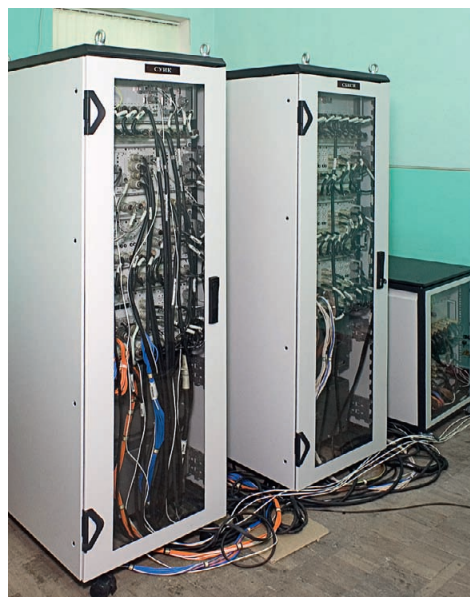
Рис. 3. Стойки АИС в процессе настройки и испытаний
